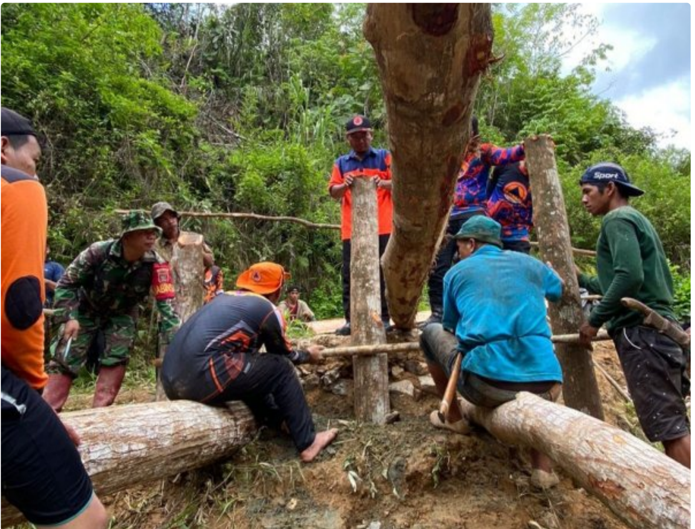
Bantu Kesulitan Rakyat, Sertu Sanu Bersama BPBD HST, Relawan dan Warga Bangun Jembatan Darurat
