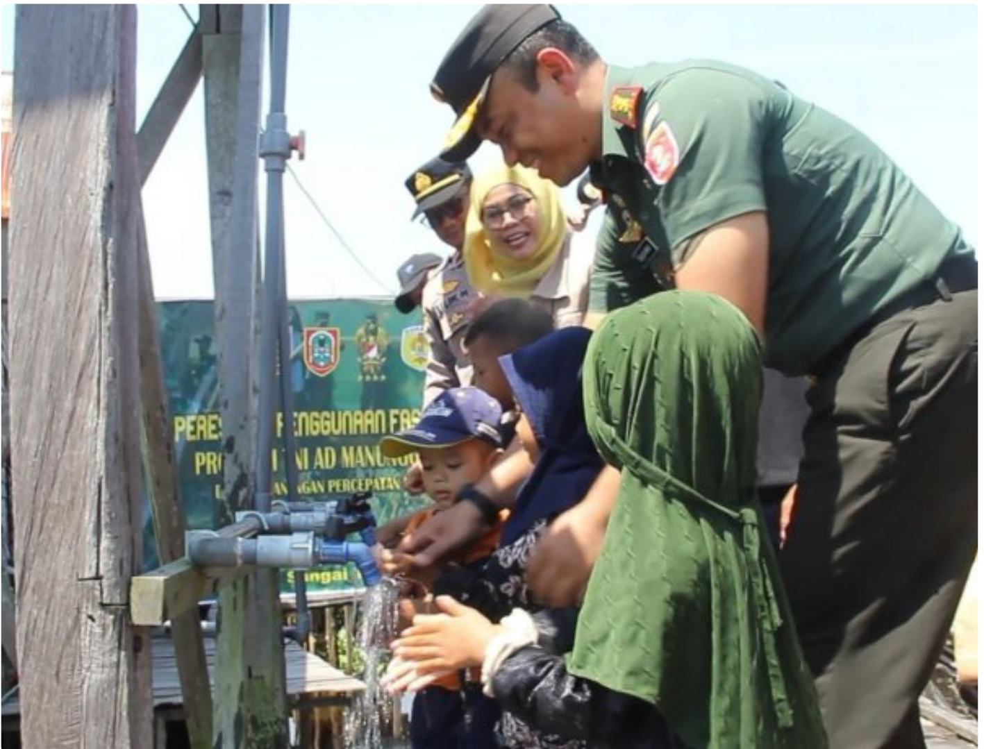
Fasilitas Air Bersih Di Awang Landas Diresmikan Dandim 1002/HST
